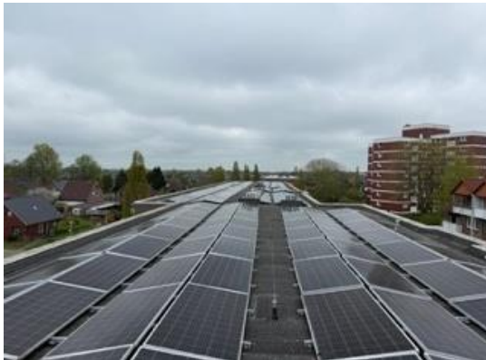
Belegung von eigenen Dächern mit PV-Modulen
