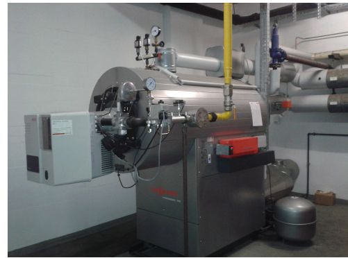
Brennwertkessel im Kreishaus Rotenburg
